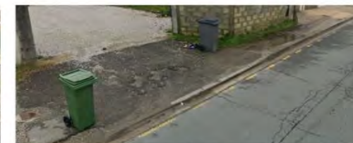
Enrobé de voirie et des entrées charretières abîmés
