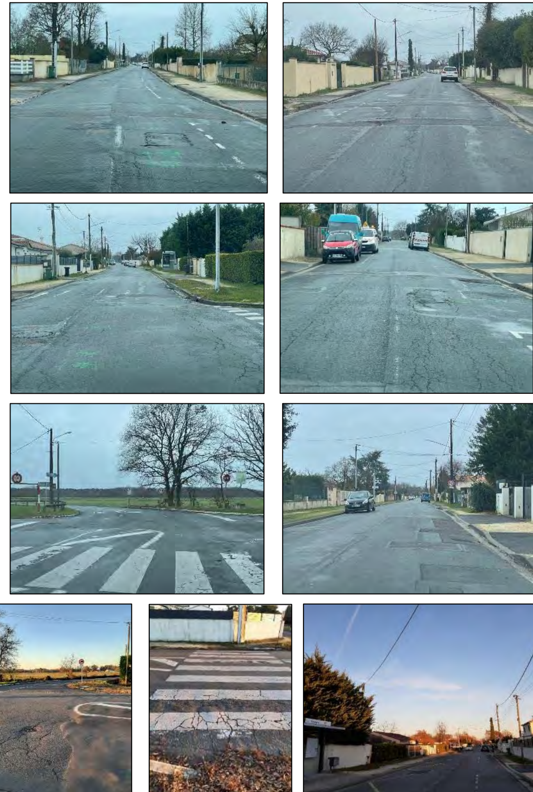
Figure 6 : Dégradations de chaussées au droit de la rue Romainville (source SETEC)
