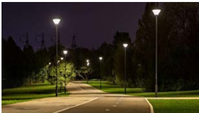
Éclairage avec des candélabres haut : 4 gommettes
