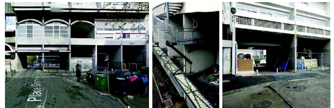
Les rez-de-chaussée dégradés et insalubres de la résidence des Aubiers (source : Bordeaux Métropole)
