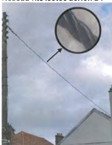
Réseau fils isolés aérien BT
