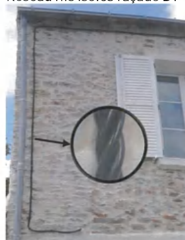
Réseau fils isolés façade BT
