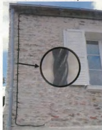
Réseau fils isolés façade BT
