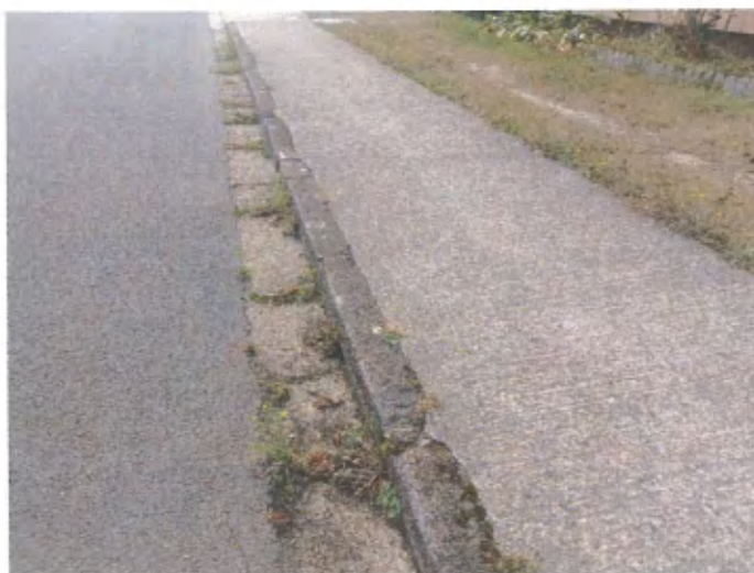
Dégradations sur bordures et caniveau rive Nord r
