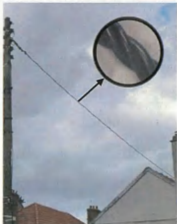
Réseau fils isolés aérien BT
