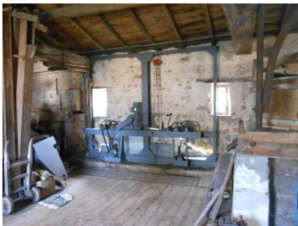
Vannes automatisées à l'intérieur du moulin
