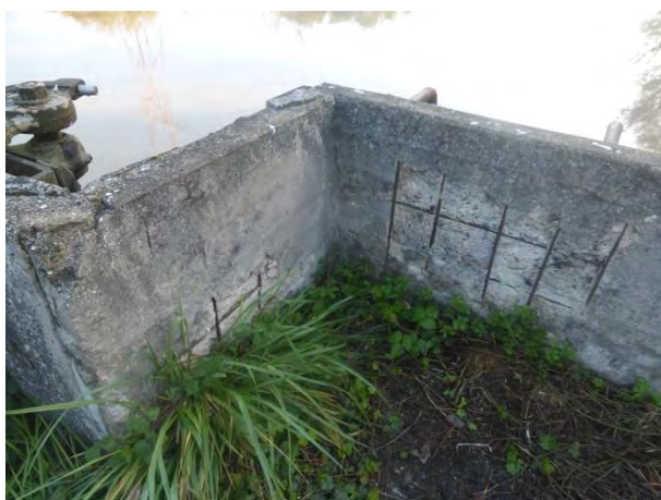
Epaufrures sur le génie civil
