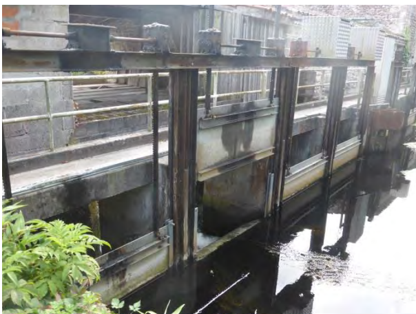
Gestion du niveau à l'aide des vannes
