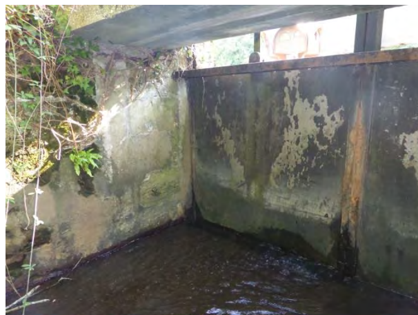
Vannes du canal de décharge
