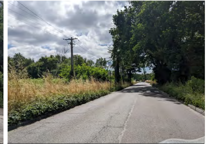
Etat dégradé de la voirie – Partie centrale de l'avenue de Touban
