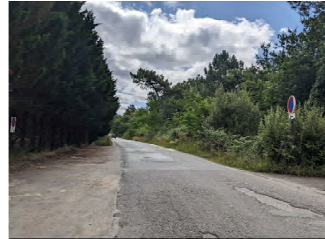
Etat dégradé de la voirie – Est de l'avenue de Touban
