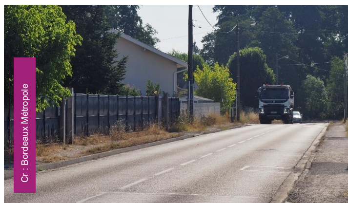
Absence d'aménagement cyclable sur le périmètre de projet et trottoirs dégradés.
