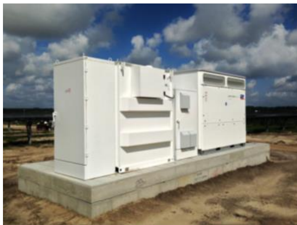
Exemple de poste de transformation
