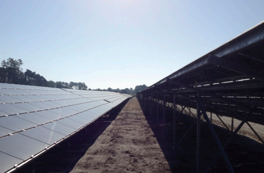
Photovoltaïque au sol
