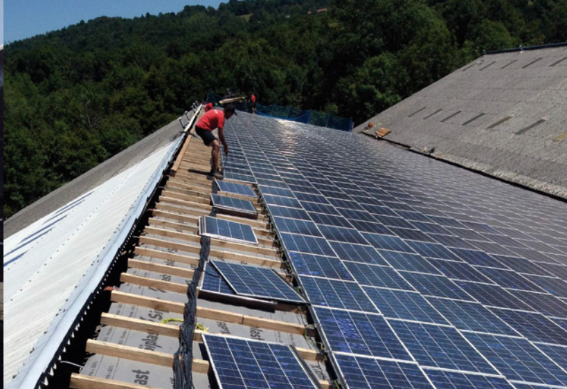
Photovoltaïque en toiture
