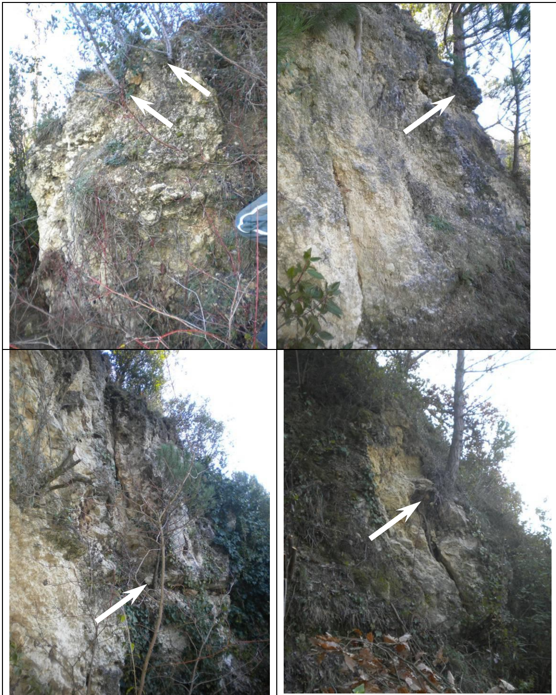
Figure 74 : Arbres mettant en péril la stabilité de blocs au niveau de la falaise
